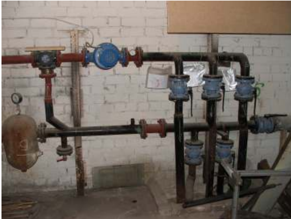
Pilt 4. II soojussõlmes asuv segamispumbaga küttesõlm
