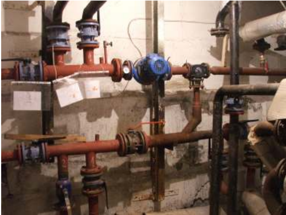
Pilt 2. I soojussõlmes asuv segamispumbaga küttesõlm
