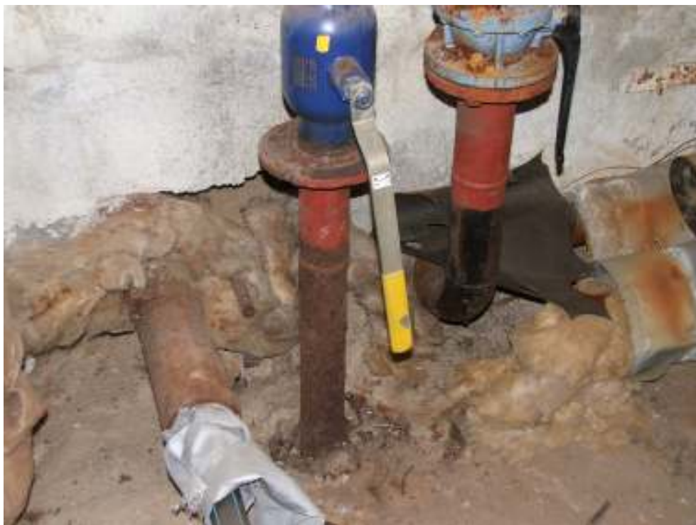
Pilt 5. Küttestorud kanalisse sisenedes
