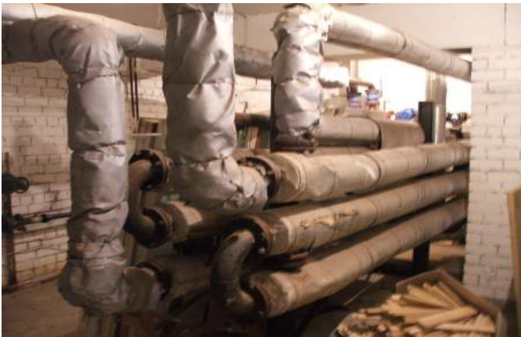
Pilt 3. I soojussõlmes asuv sooja tarbevee ettevalmistamise toru-torus soojusvaheti
