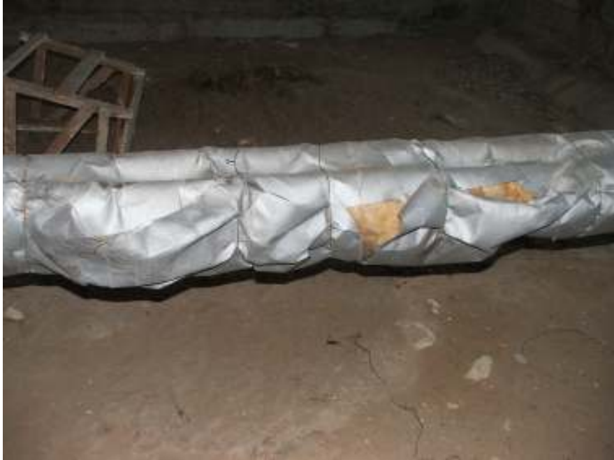
Pilt 7. Allavajunud isolatsioon küttesüsteemi magistraaltorudel
