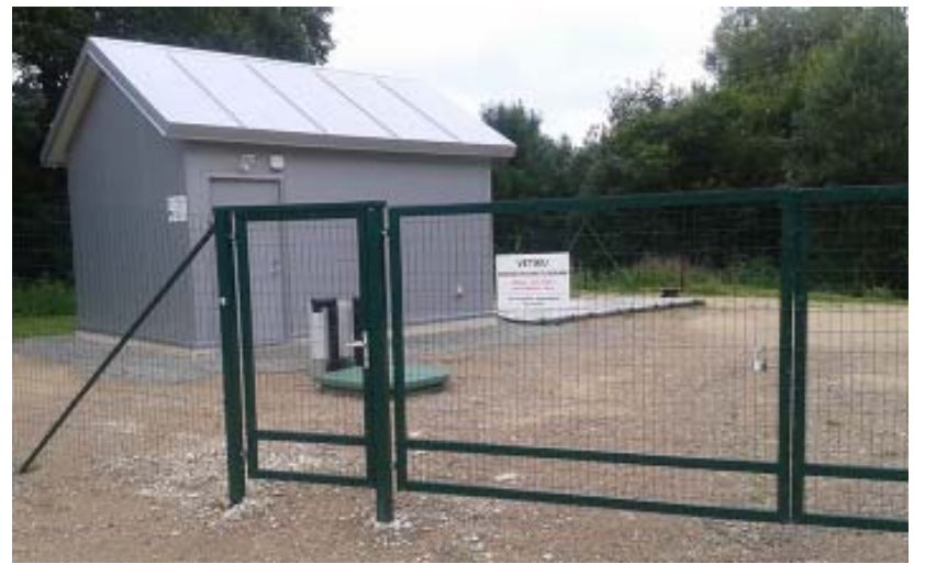
Vetiku reoveepuhasti. Foto: Peep Võrk
